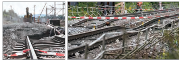
[그림 15] Rastatt 철도 TBM 터널 사고(독일 Rastatt, 2017)
