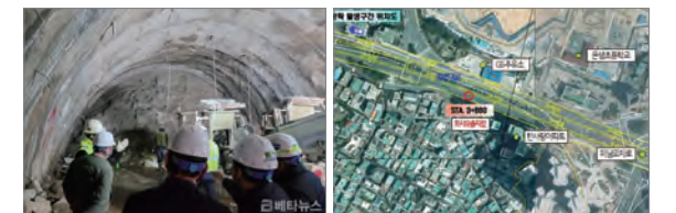
[그림 24] 부산 지하도로 NATM 터널 붕락사고 (2023, 부산)
