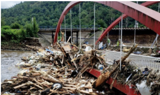
<그림 3> 교량 피해 사례 (벨기에(1) 교량)
