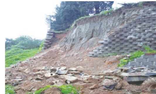
<사진 1> Failure of SRW
