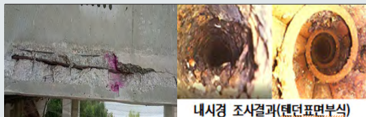
〈청담1교 내부텐던 부식발견 (2020.9)〉 (10ton 이하 중량제한 : 9.28 ~ 11.10)
