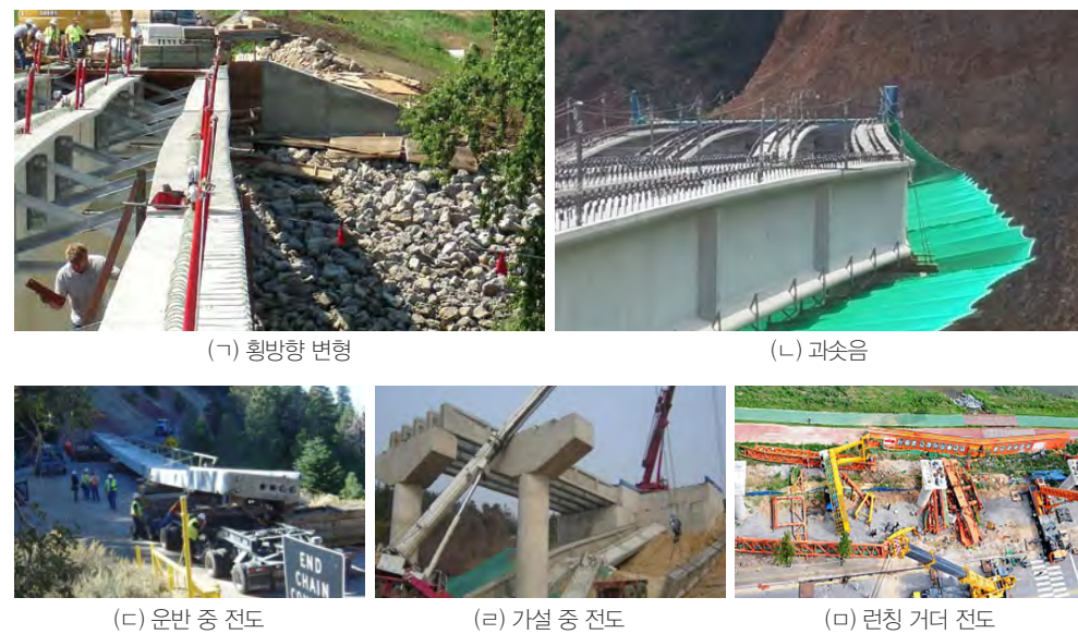
〈그림 3〉 PSC 교량의 시공 시 문제점
