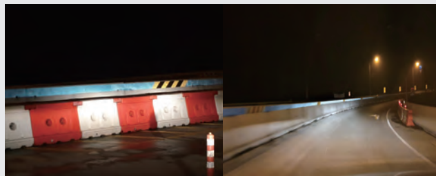
강원도 삼척 오십천교 중앙분리대 반사페인트 야간 반사효과
