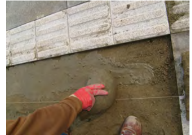
사모래 포설 후 물을 붓는 현장(잘못된 사례)
