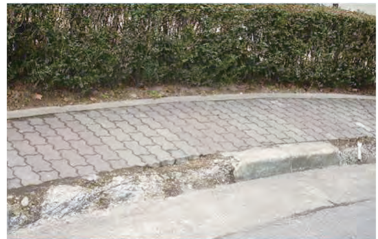
〈그림 1〉 동결로 인한 경계블록 파손(과거 생산 방법)
