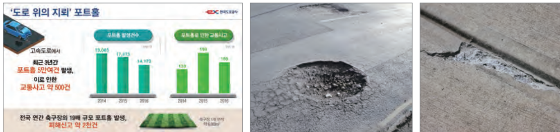
〈그림 2〉 도로포장 파손의 사례
