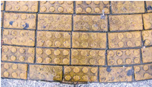
〈그림 19〉 일반 콘크리트 점자블록의 마모 사례
