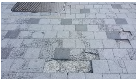
〈그림 14〉 콘크리트 블록 표층 균열 및 탈리 사례
