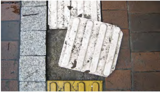
〈그림 17〉 도자 점자블록 파손 사례
