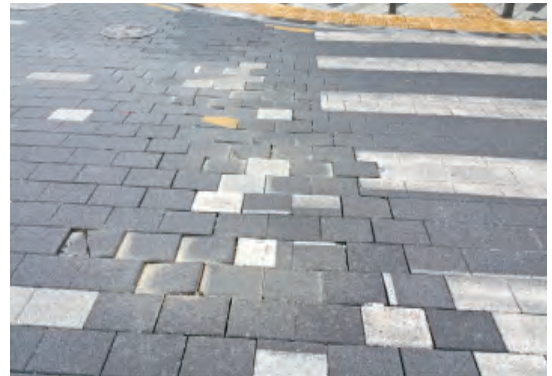
〈그림 2〉 줄눈모래 유실로 인한 파손(대전시 사례)
