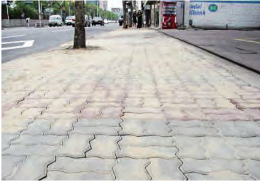
〈그림 5〉 흩뿌려 놓은 줄눈모래(잘못된 시공)
