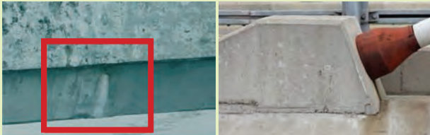
슬래브 측면 백태
