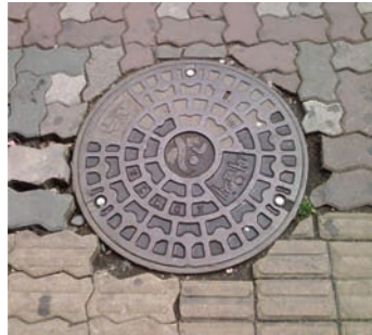
대충 시공된 맨홀 주변 보도블록
