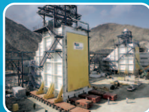
HRSG분야 Global top-tier (HRSG: Heat Recovery Steam Generator)
