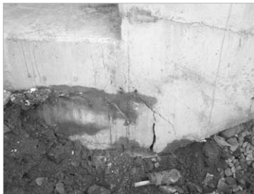
날개벽 하부 인장균열 발생
