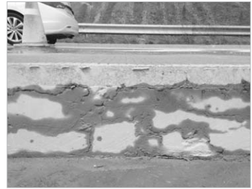
콘크리트 내부 수평균열
