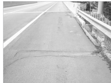
갓길 포장 균열
