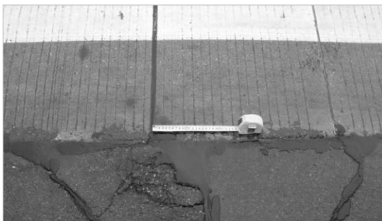
<그림 9> 삼정교 포장 팽창(←교량 방향)
