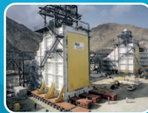
HRSG분야 Global top-tier (HRSG: Heat Recovery Steam Generator)
