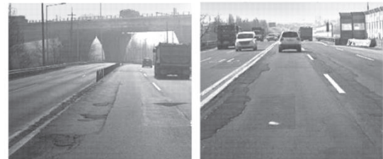
(a) 부적합한 보수로 소파보수, 팻칭 반복
