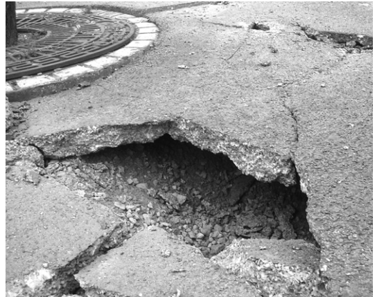
그림 1. 동상에 의해 포장 하부에 공동이 발생한 사진
