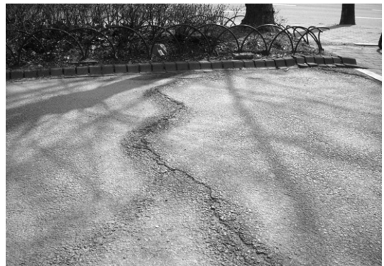
그림 2. 나뭇가지 뿌리에 의해 포장체 파손이 발생한 사진
