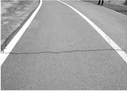
그림 3. 환경하중에 의한 온도 균열
